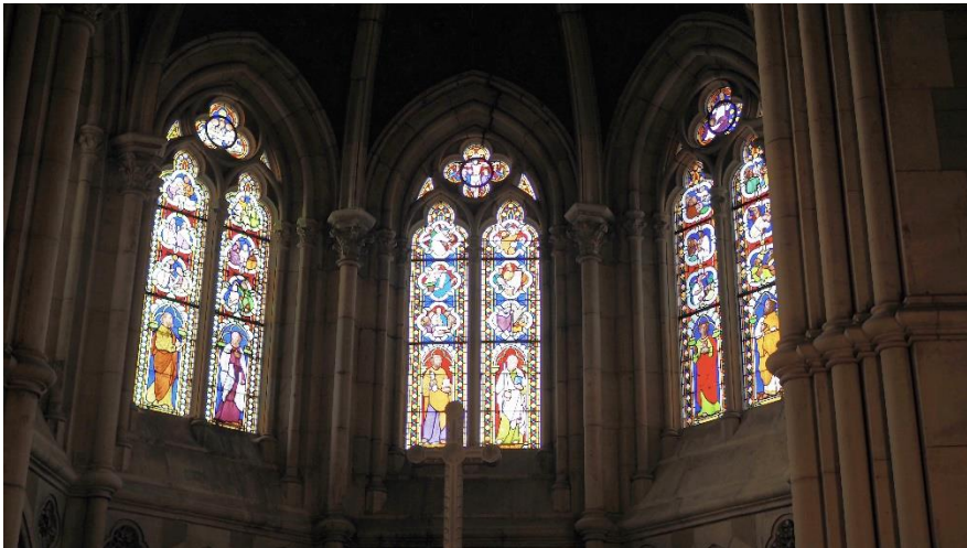
Auf den ersten Blick sah man den Fenstern den schadhafte Zustand nicht an. Das Bild wurde vor der Restaurierung aufgenommen. Foto: E. Schröder
